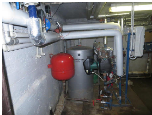
36.attēls. Pagrabs (telpa Nr.33- siltummezgls)
